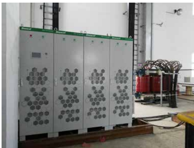
Система компенсации реактивной мощности 2760 квар для шахтного подъемника
