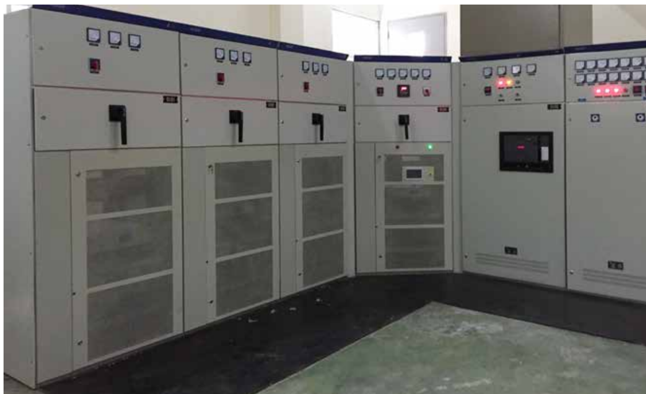
Пример. Конденсаторные установки заменены на модули SVG
